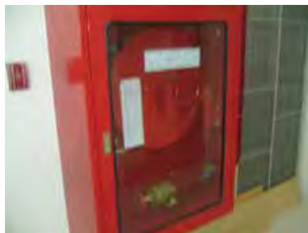
รูปที่ 21 การจัดเตรียมอุปกรณ์ดับเพลิงเบื้องต้น
